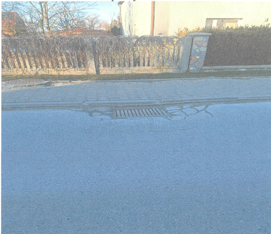
Uszkodzona studzienka oraz chodnik obok posesji Gołuchowice 25
