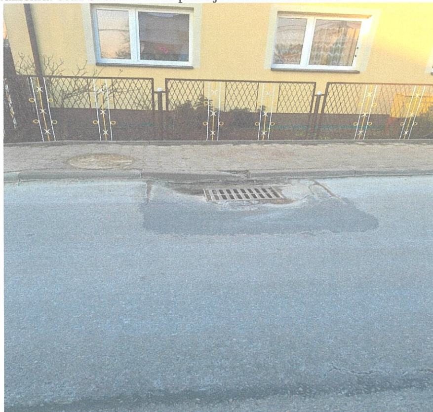
Uszkodzona studzienka oraz chodnik obok posesji Gołuchowice 121
