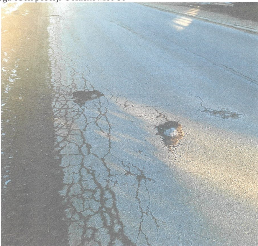
Uszkodzona droga obok posesji Gołuchowice 58
