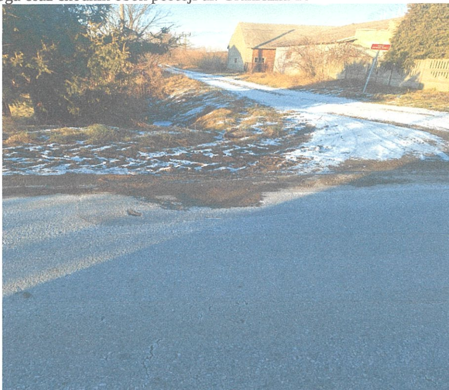
Uszkodzona droga oraz chodnik obok posesji ul. Graniczna 10
