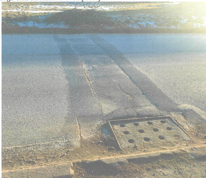
Uszkodzona droga oraz studzienka obok posesji ul. Graniczna 7
