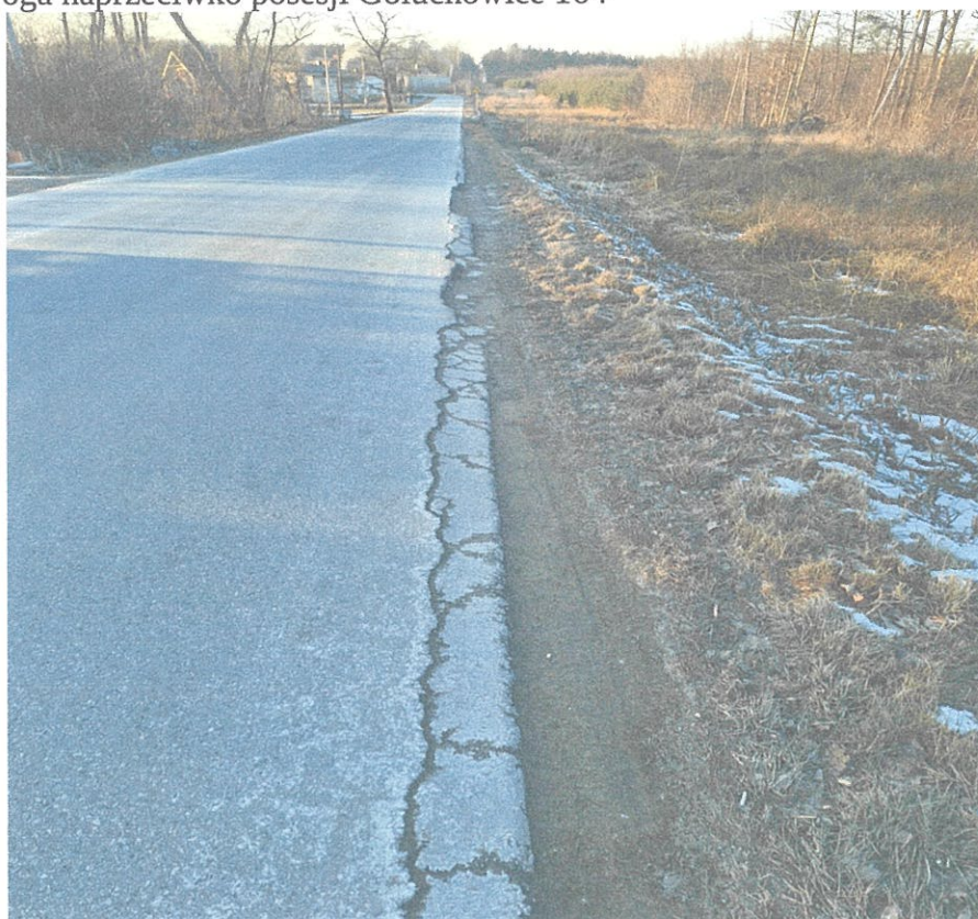
Uszkodzona droga naprzeciwko posesji Gołuchowice 164
