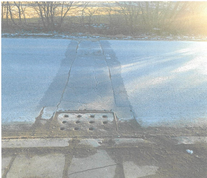
Uszkodzona droga oraz studzienka obok posesji ul. Graniczna 10
