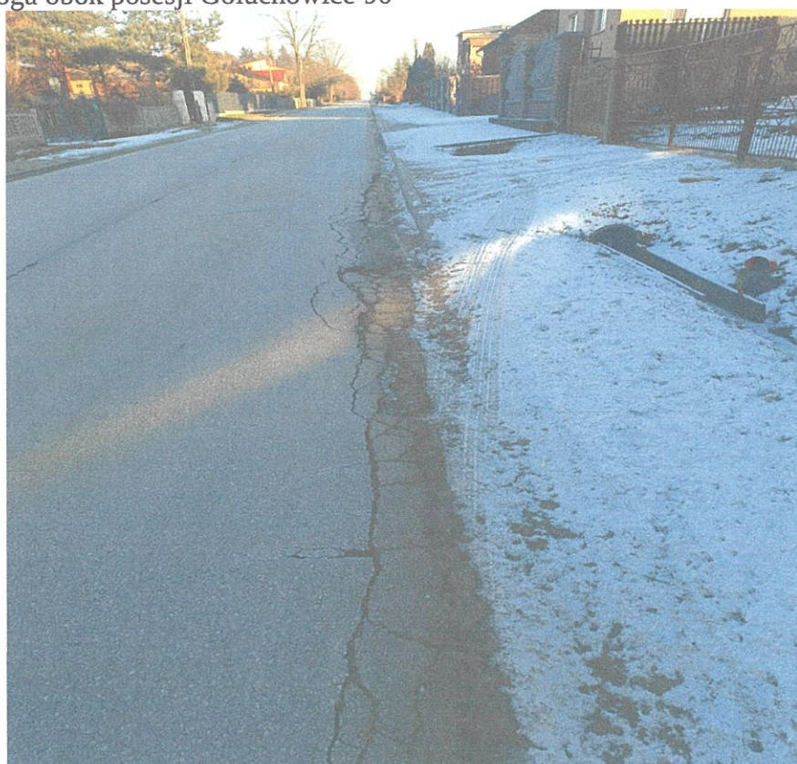
Uszkodzona droga obok posesji Gołuchowice 90
