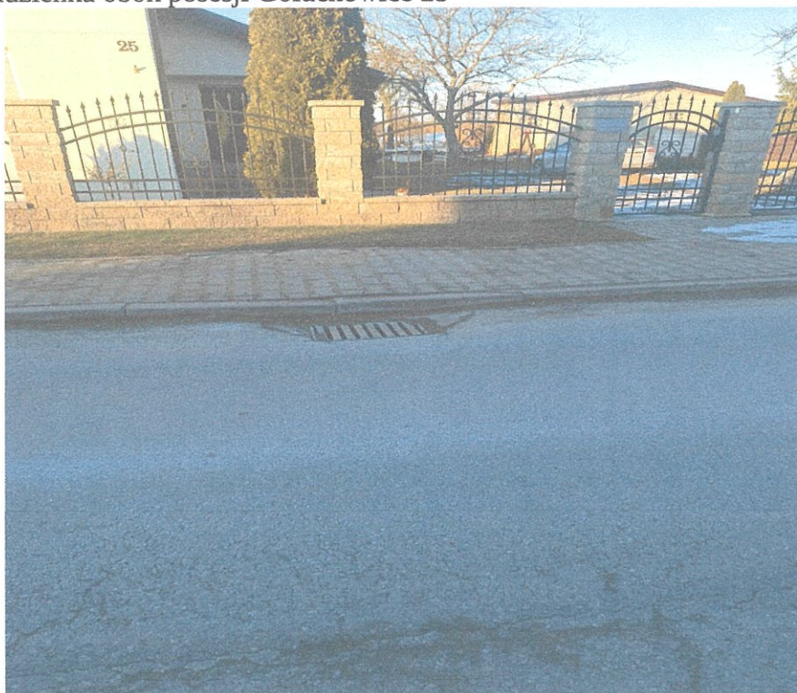
Uszkodzona studzienka obok posesji Gołuchowice 25
