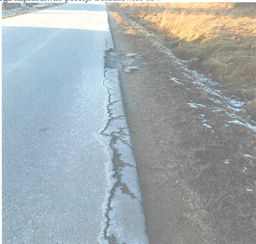
Uszkodzona droga naprzeciwko posesji Gołuchowice 154
