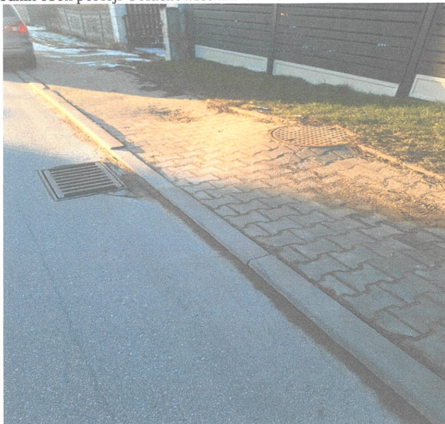
Uszkodzona chodnik obok posesji Gołuchowice 117
