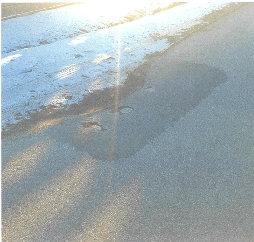
Uszkodzona droga obok posesji Gołuchowice 108
