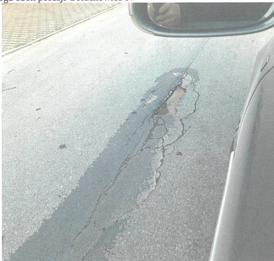
Uszkodzona droga obok posesji Gołuchowice 97
