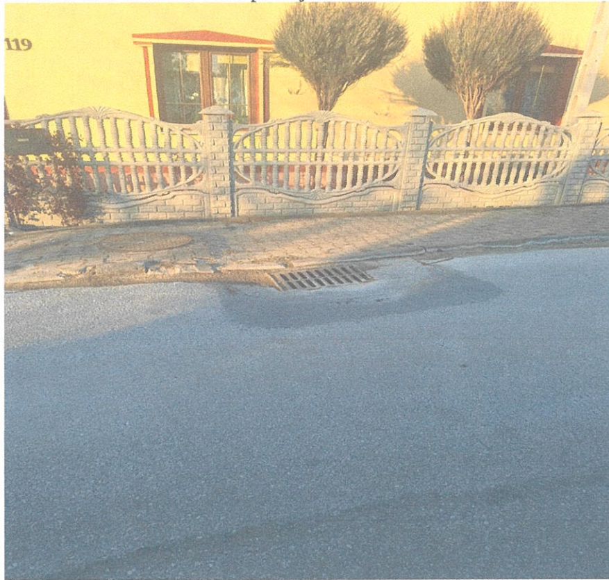
Uszkodzona studzienka oraz chodnik obok posesji Gołuchowice 119
