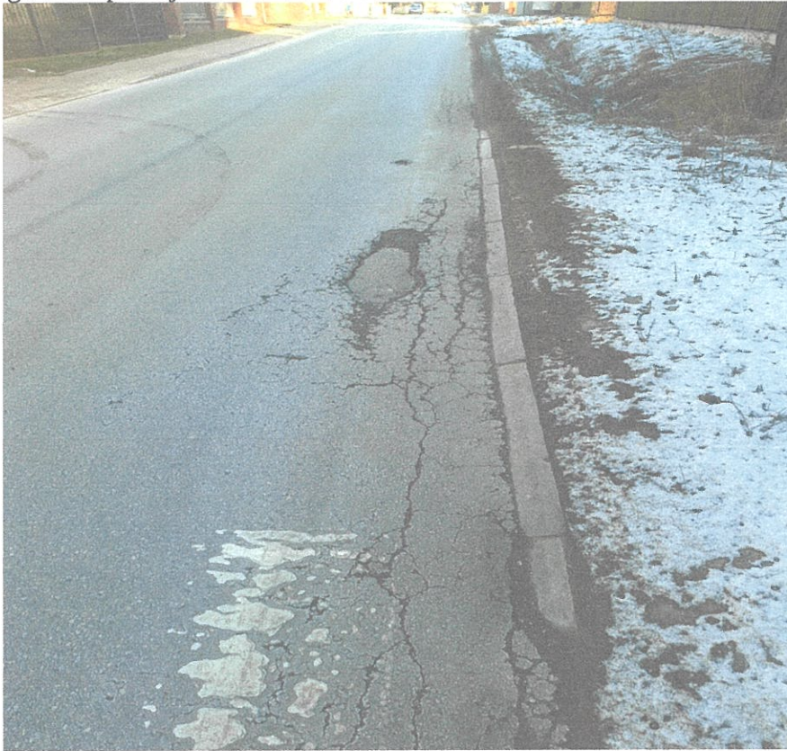
Uszkodzona droga obok posesji Gołuchowice 60
