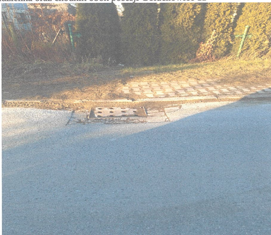
Uszkodzona studzienka oraz chodnik obok posesji Gołuchowice 11
