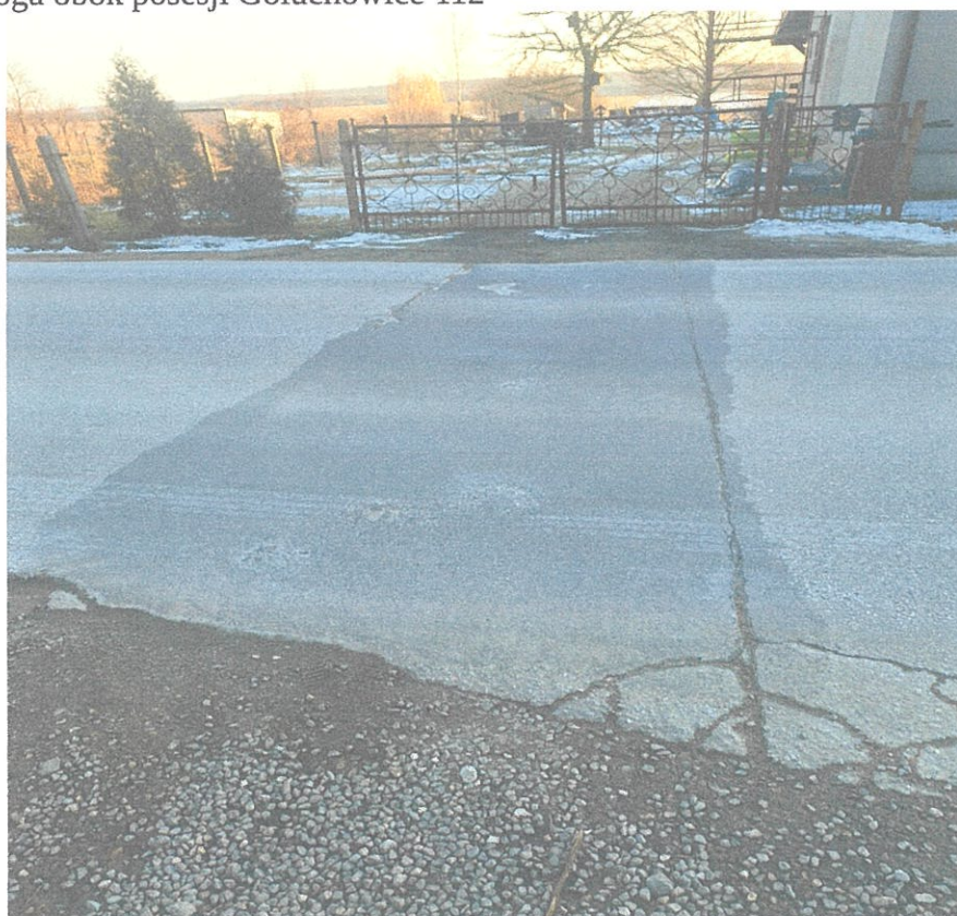
Uszkodzona droga obok posesji Gołuchowice 112
