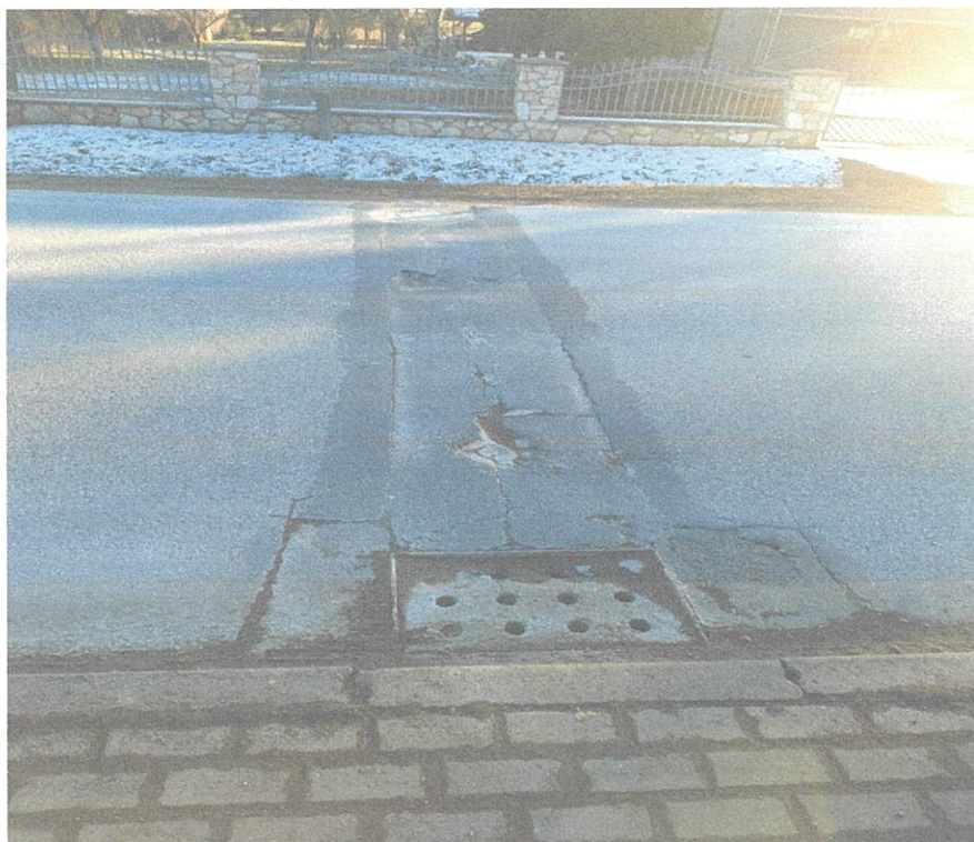
Uszkodzona droga oraz studzienka obok posesji ul. Graniczna 7a
