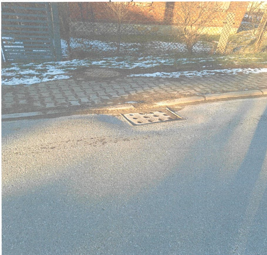
Uszkodzona studzienka oraz chodnik obok posesji Gołuchowice 75
