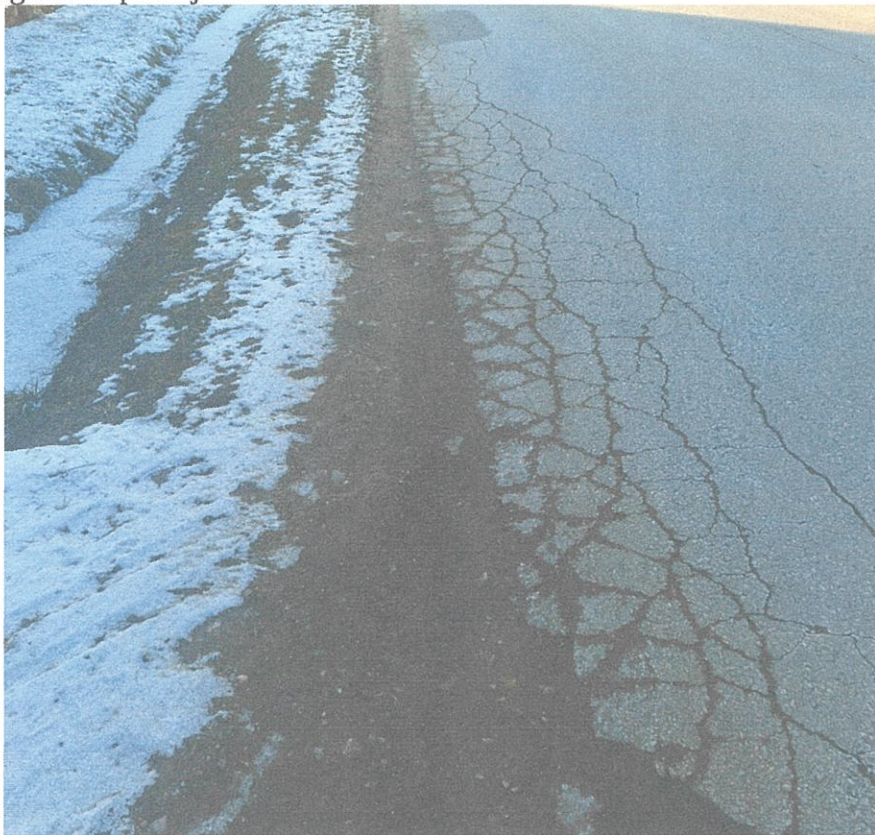
Uszkodzona droga obok posesji Gołuchowice 56
