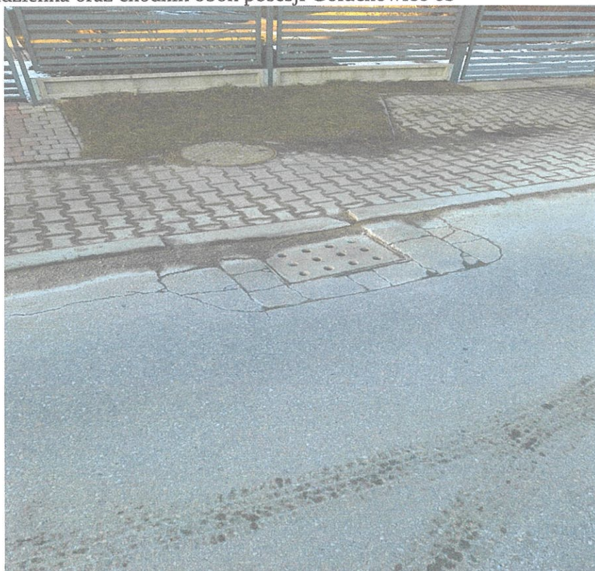
Uszkodzona studzienka oraz chodnik obok posesji Gołuchowice 63
