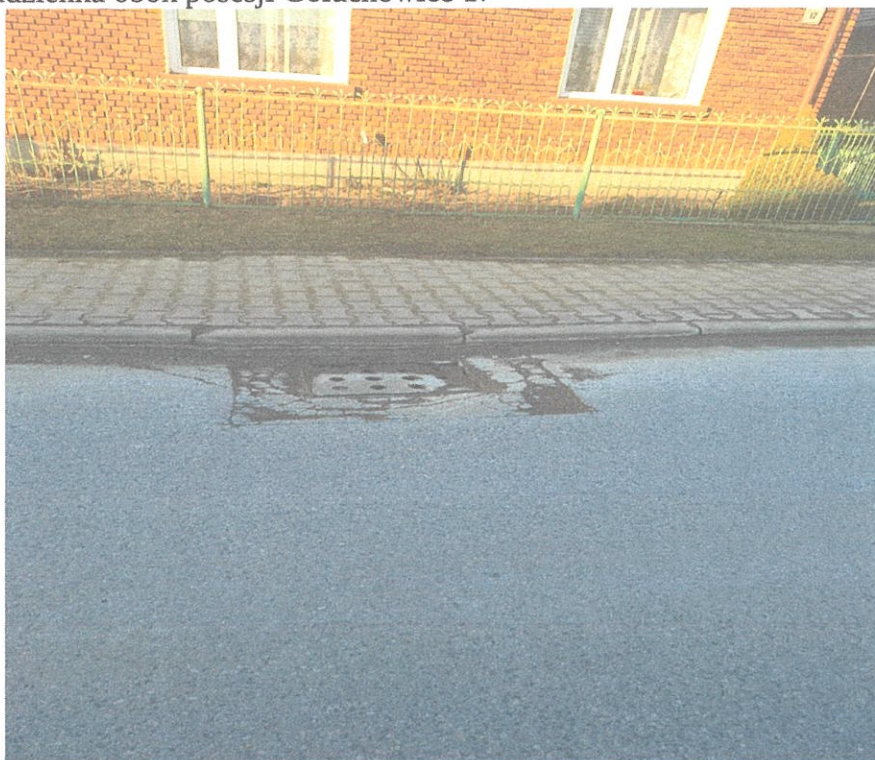
Uszkodzona studzienka obok posesji Gołuchowice 17
