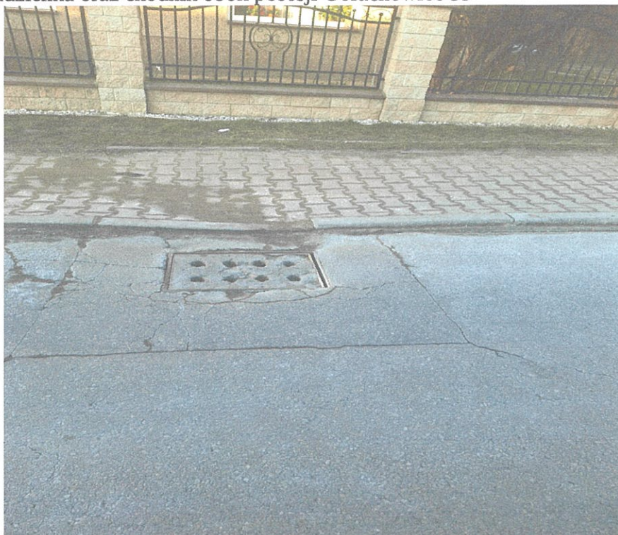
Uszkodzona studzienka oraz chodnik obok posesji Gołuchowice 59
