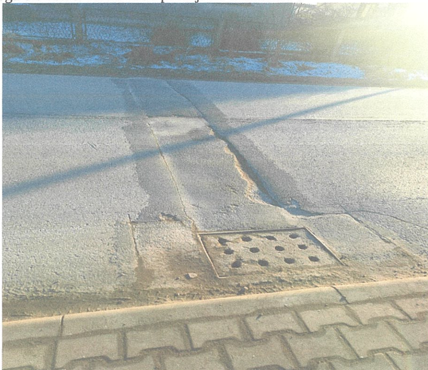
Uszkodzona droga oraz studzienka obok posesji ul. Graniczna 9
