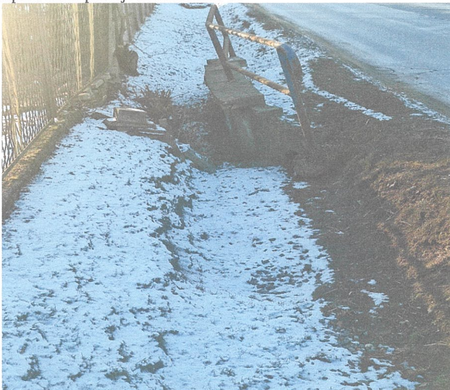
Uszkodzony przepust obok posesji Gołuchowice 36
